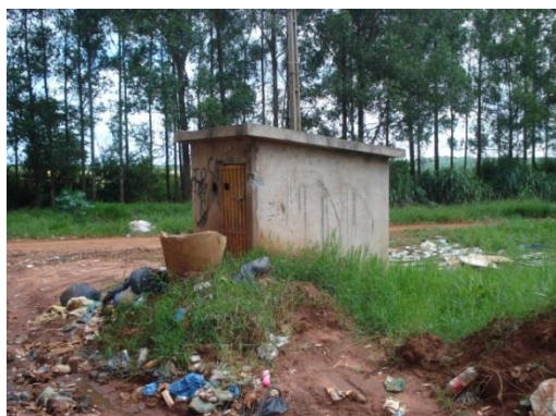
Comando elétrico da bomba de recirculação
