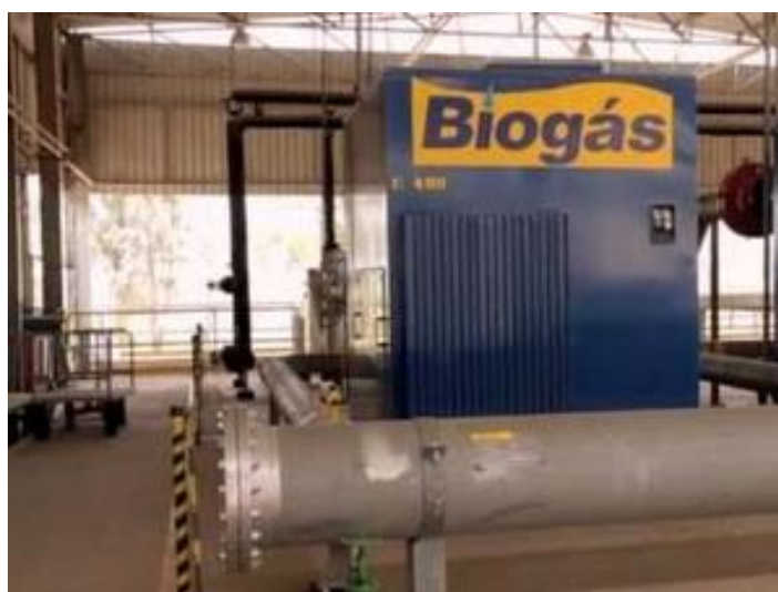
Figura 273. Usina Termelétrica da Biogás Fonte: Revista Época, 2013.
