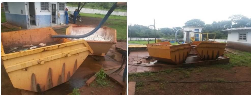
Figura 164. Armazenamento de lodo do gradeamento e caixa de areia Fonte: HABITAT ECOLÓGICO, 2015.
