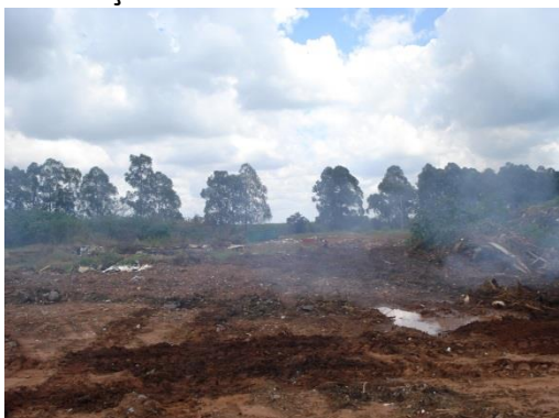
Entulhos e Resíduos de Construção Civil
