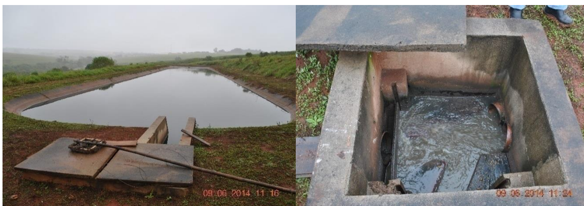
Figura 182. Lagoas de tratamento de esgoto Fonte: PMSB-Diagnóstico - DRZ, 2015.
