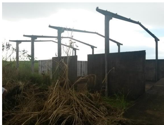
Figura 152. Barracão para triagem de resíduos desativado. Fonte: HABITAT ECOLÓGICO, 2015.
