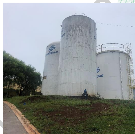
Imagem 8 Reservatórios do município de Turvo-PR
