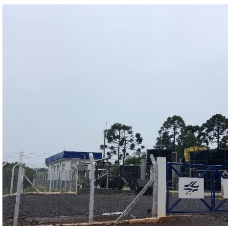
Imagem 9 Visão da entrada da ETE de Turvo-PR
