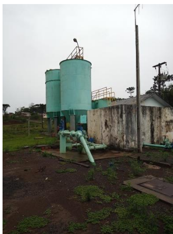
Imagem 5 Visão da ETA de Turvo-PR
