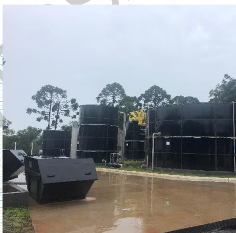
Imagem 11 Vista dos tanques de tratamento
